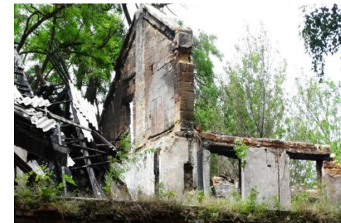
Детский сад на 90 мест в с.Б.Кооператор, числится с 1998 года и имеет «иной статус объекта»
