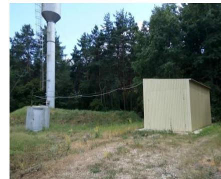
Станция очистки воды модульного типа в с. Новоуглянка Усманского района
